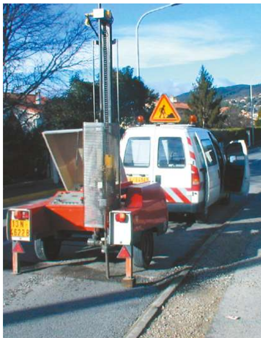
Figure 38 : Reconnaissance au pénétrodensitographe d'un remblai fissuré en crête – le défaut est lié à un sous-compaction de la zone latérale du remblai qui se manifeste par un tassement différentiel (Source : Cerema Normandie-Centre)
