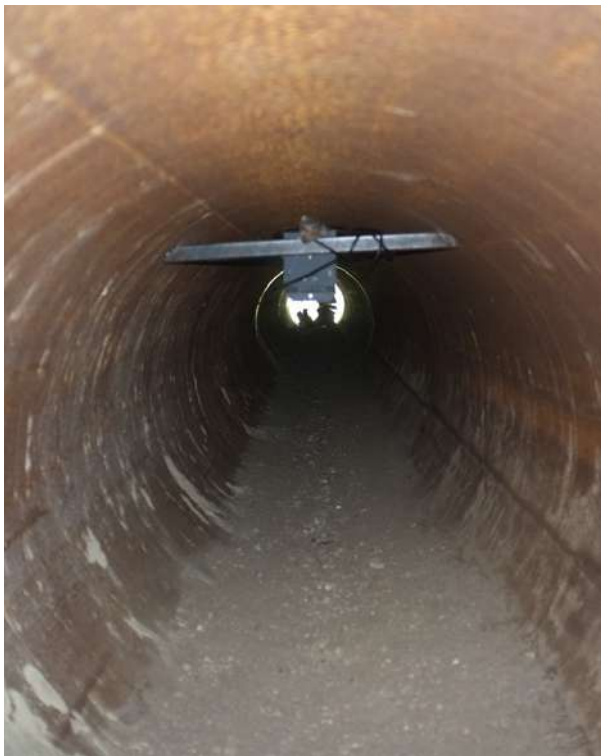
Illustration 19 : Vue sur dispositif de suivi réalisé par Cofiroute.
