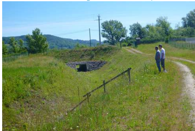
Cadre sous une route permettant la continuité d'un canal de transit vers un bassin
