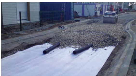
Figure 64 : Chaussée à structure réservoir - photo : (Syndicat Intercommunal du Bassin d'Arcachon, 2013)
