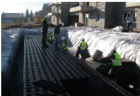
Figure 66 : Lotissement rue de Béguey – Artigues-près-Bordeaux (Communauté Urbaine de Bordeaux, 2014)
