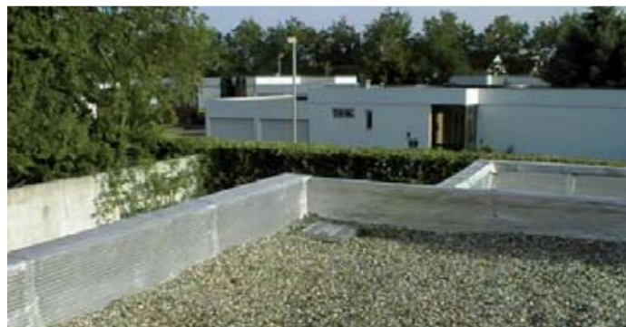
Figure 51 : Toiture-terrasse stockante (Communauté Urbaine du Grand Lyon, 2008)
