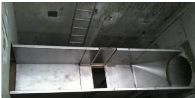
Figure 95 : Photo d'un piège à charriage à Marseille
