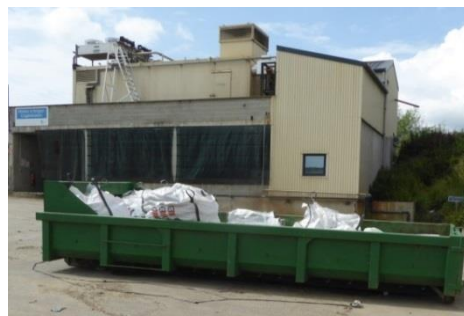
Conteneurs avec des déchets d'amiante. Source: A2Conseils sprl
