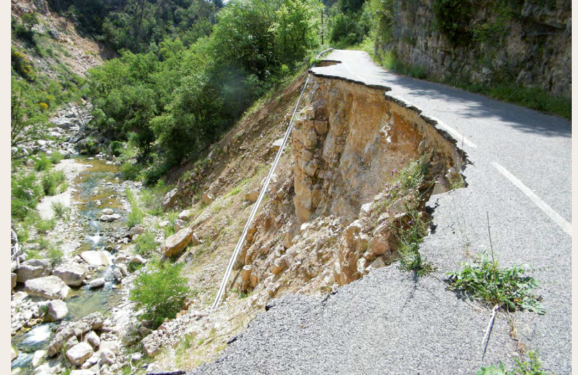
Effondrement de chaussée - © Cerema
