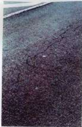
Faïençage fin ne nécessitant pas d'entretien courant
