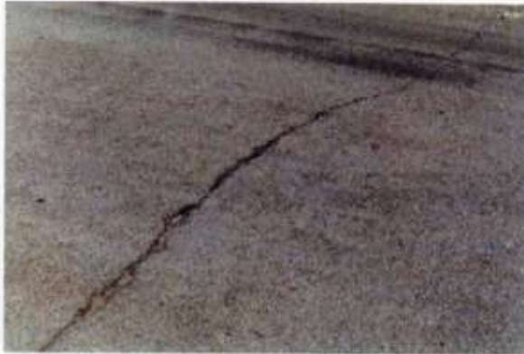
Fissure nécessitant un pontage
