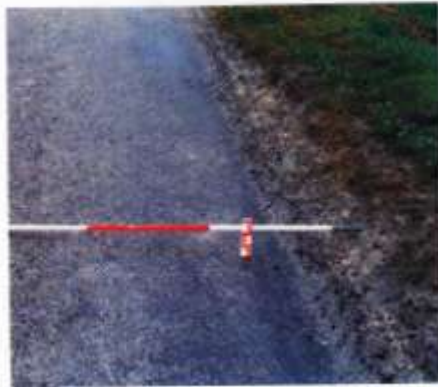
Affaissement de plus de 5 cm nécessitant un reprofilage
