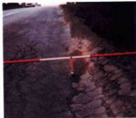
Affaissement nécessitant une purge
