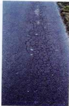
Faïençage nécessitant un scellement et une imperméabilisation
