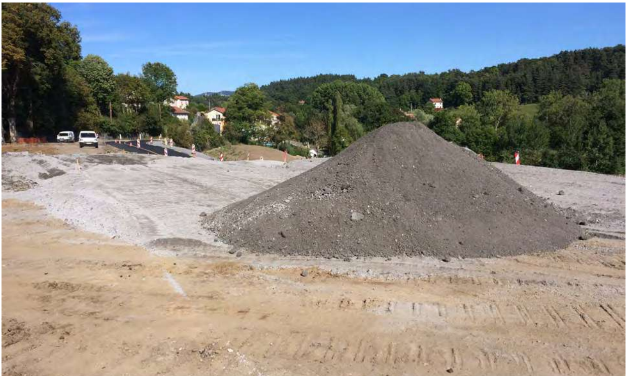
Grave de Mâchefers d'Incineration de Déchets Non Dangereux, juste approvisionnée @Cerema (Sébastien LIANDRAT)
